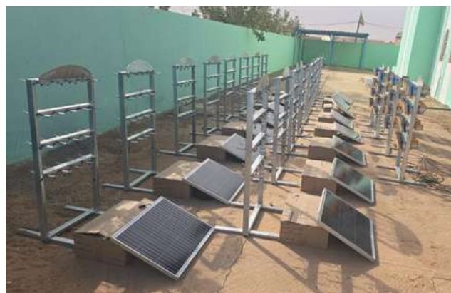
Les stations de recharge
